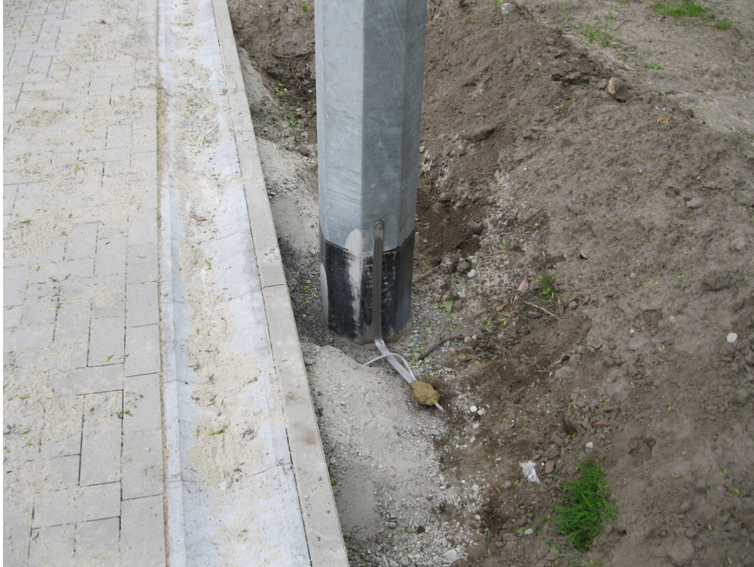
Bild 19 + 20: Maßnahmen der Potentialsteuerung im Bereich von Flutlichtmasten mittels Erdungsanschlüssen und vermaschten Erdungssystemen aus Edelstahl V4A
