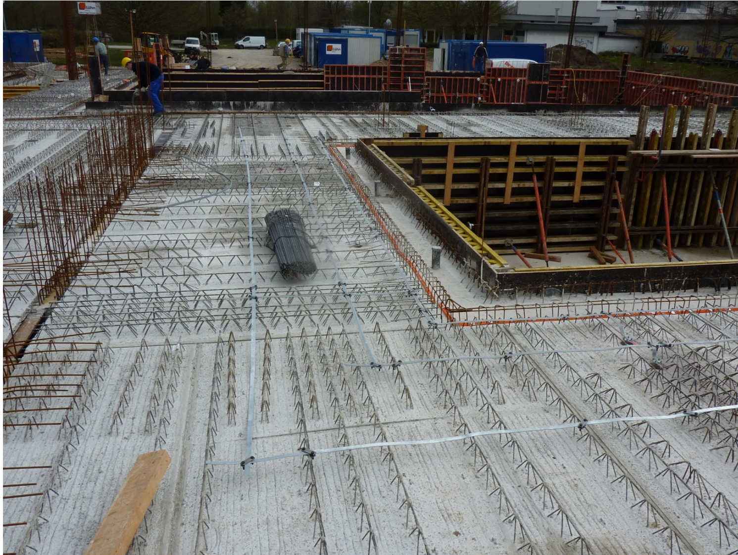
Bild 22 + 23: Erstellung einer Potentialsteuerung in Form eines vermaschten Erdungssystems bestehend aus drei Ringen um ein Schwimmbecken innerhalb der Betondecke mit Anschluss der Bewehrung
