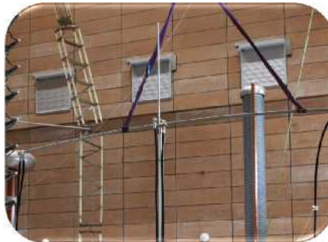
4 isolierte Ableitungen (außen)
