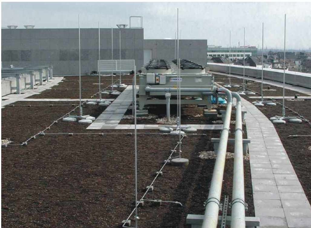
Bild 16: Schutz der Rückkühlanlage eines Bankgebäudes mit Backup-Server
