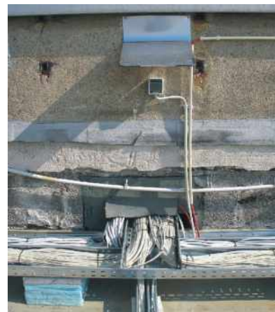
Bild 2: Steuer- und Versorgungsleitungen für die klimatechnischen Dachaufbauten
