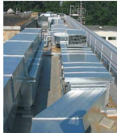
Bild 1: Nachträglich installierte klimatechnische Dachaufbauten
