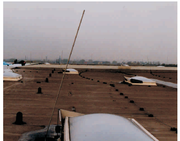
Bild 3: Fangstange mit defekter Befestigung
