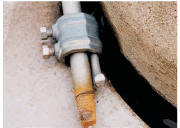
Bild 4: Fangstange mit zerstörtem Gewinde und abgescherter Fangleitung
