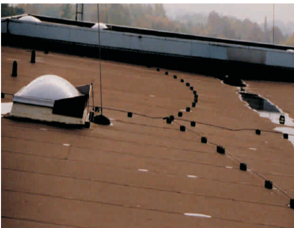
Bild 2: Fangleitung durch Windeinfluss verschoben
