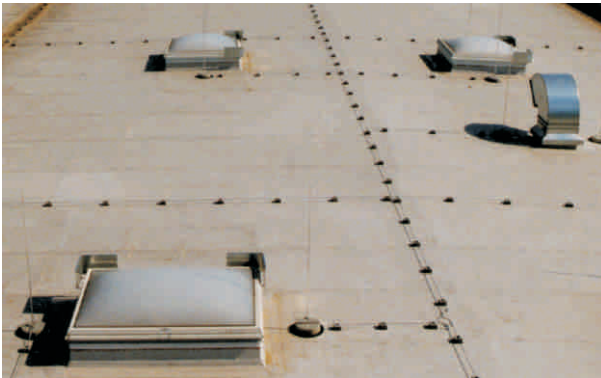
Bild 1: Fangleitung, Montage gemäß DIN 48803
