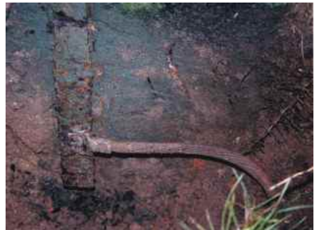
Bild 1: Korrodierte Erdungsleitung in einer 10 kV Umspananlage
