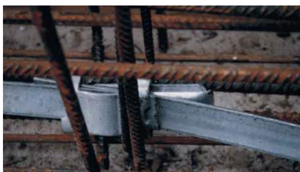
Bild 2: Falsch montierter Keilverbinder
