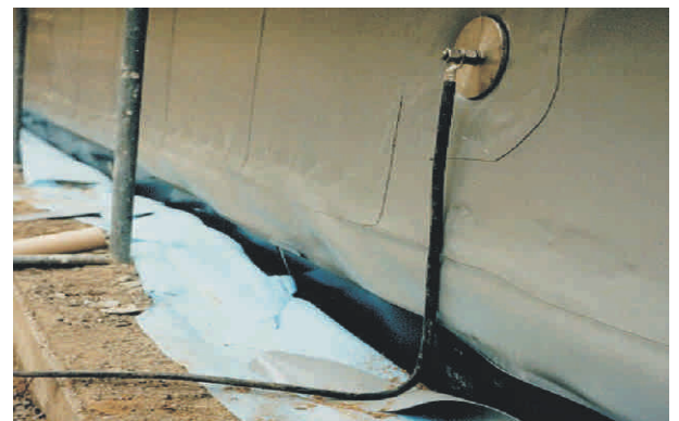
Bild 1 : Erdungsfestpunkt als Erderdurchführung bei Wandendichtung mit Anschlussfahne Kabel 1x50 mm 2
